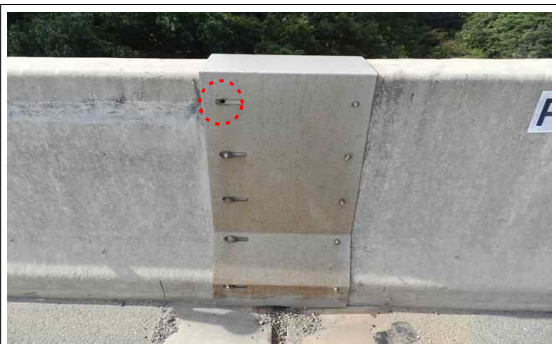
부대시설 하행선 P2 차수관 앵커탈락
