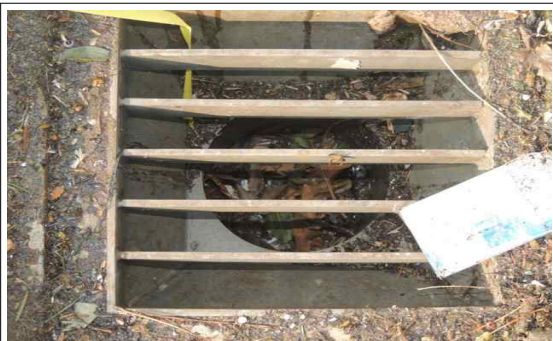
배수시설 하행선 S17 배수구 막힘
