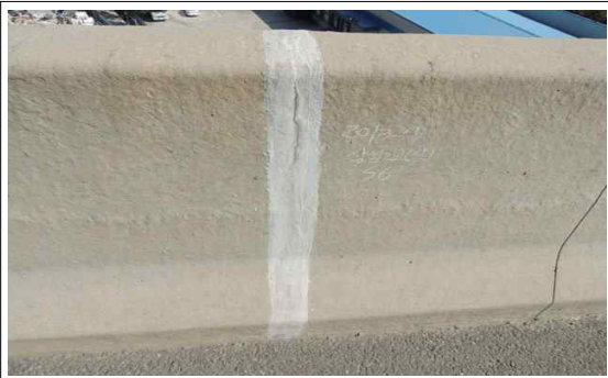
방호벽 하행선 S1 보수부 재균열(CW=0.2mm)
