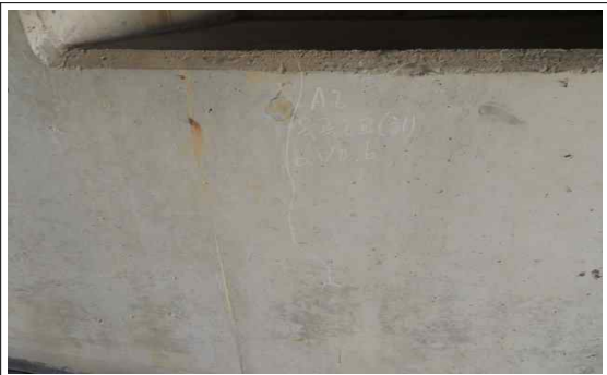
교대 하행선 A2 구체 수직균열(CW=0.1mm)
