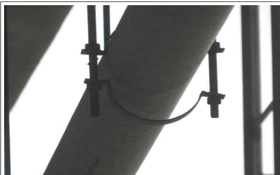
배수시설 하행선 S12 배수관 고정고리 탈락
