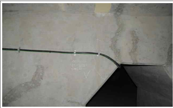
주형내부 상행선 S3 부산측 격벽 균열 (CW=0.1mm)
