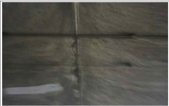
하행선 천정부 J51 콘크리트 탈락 (A=0.1X0.3)
