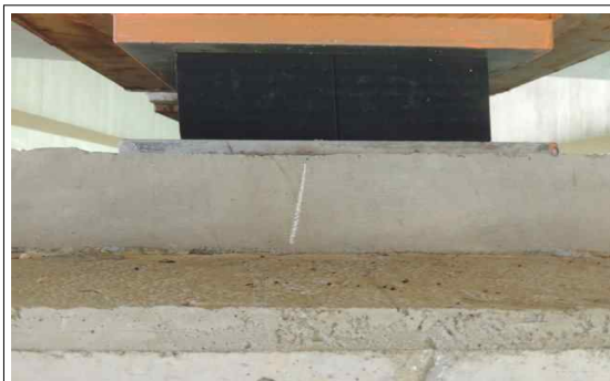
교량받침 하행선 P1-SH7 무수축물탈 균열 (CW=0.1mm)
