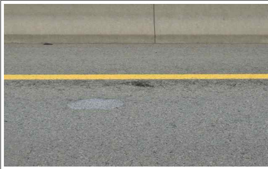
교면포장 상행선 S4 아스콘 패임
