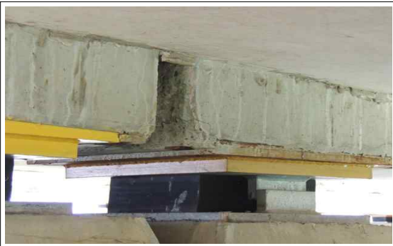
주형 하행선 S1-G4 플레이트 매립부 파손
