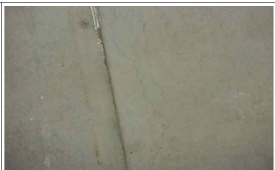
바닥판하면 하행선 S3 종방향균열(CW=0.2mm)
