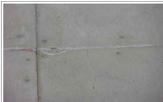
바닥판하면 하행선 S2 종방향균열(CW=0.2mm)
