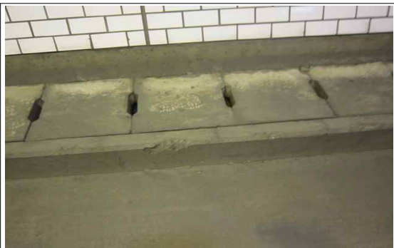
하행선 공동구 S78 콘크리트 파손
