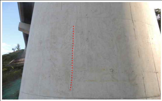
교각 상행선 P1 기둥부 수직균열(CW=0.1mm)
