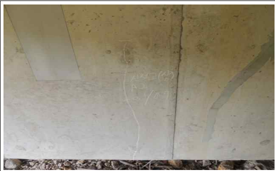
교대 상행선 A2 수직균열(CW=0.1mm)
