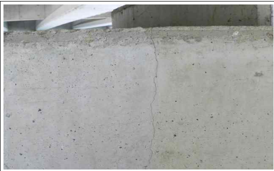
교각 상행선 P3 코핑부 수직균열(CW=0.2mm)
