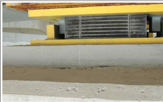
교량받침 상행선 P2-SH8 무수축물탈 균열 (CW=0.1mm)
