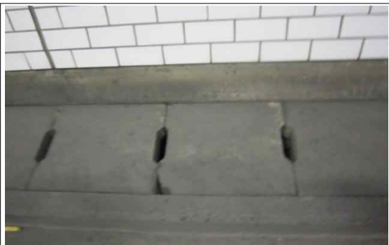
하행선 공동구 S33 덮개파손
