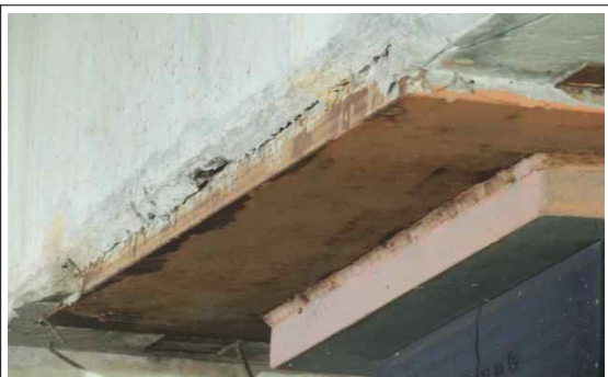
교량받침 하행선 P5-SH8 Plate 부식
