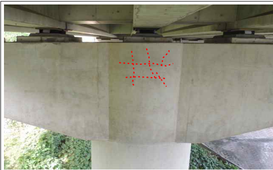
교각 하행선 P6 코핑부 망상균열
