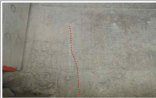
교대 하행선 A1 흥벽 수직균열(CW=0.1mm)
