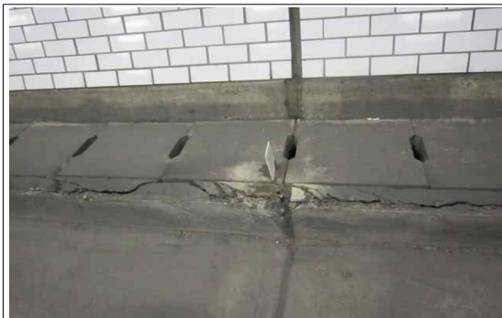
하행선 공동구 S51 콘크리트 파손
