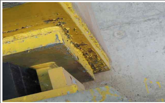
교량받침 상행선 A1-SH3 Plate 도장손상
