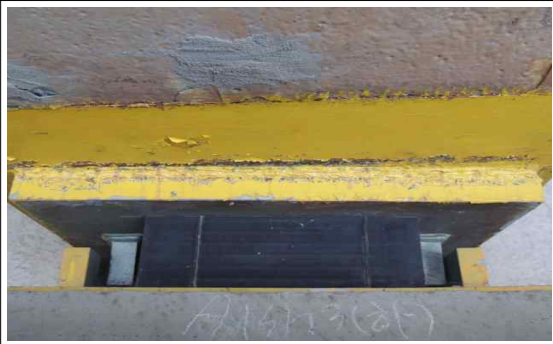
교량받침 하행선 A1-SH3 Plate 부식
