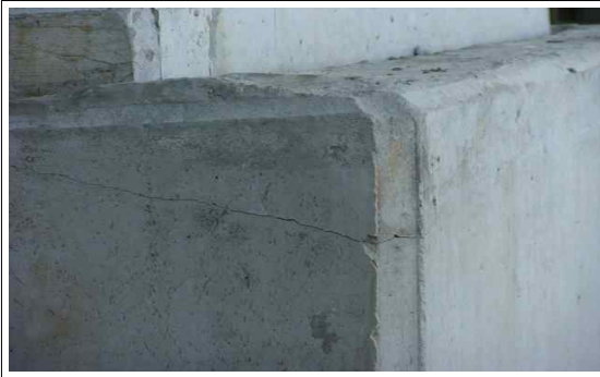
교각 상행선 P1 코핑부 균열(CW=0.3mm)
