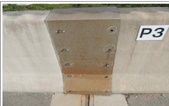
부대시설 상행선 P2 차수관 앵커탈락
