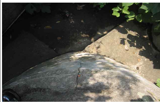
산마루측구 균열 (81.14K 지점)
