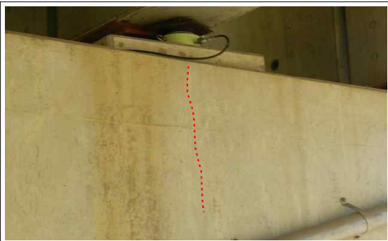
교각 하행선 P2 코핑부 수직균열(CW=0.1mm)
