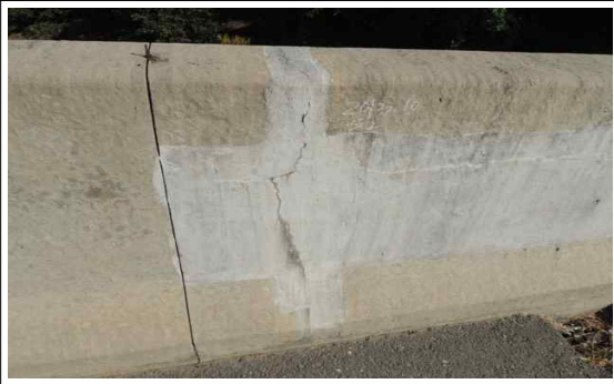
방호벽 상행선 S2 보수부 재균열(CW=0.2mm)
