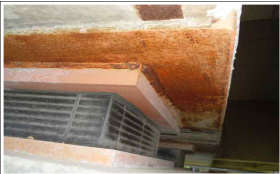
교량받침 상행선 P3-SH9 상부플레이트 부식
