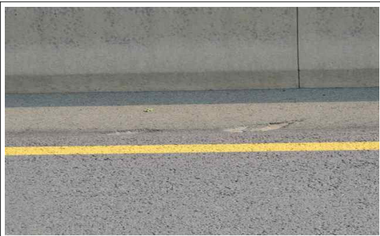
교면포장 하행선 S17 아스콘 패임
