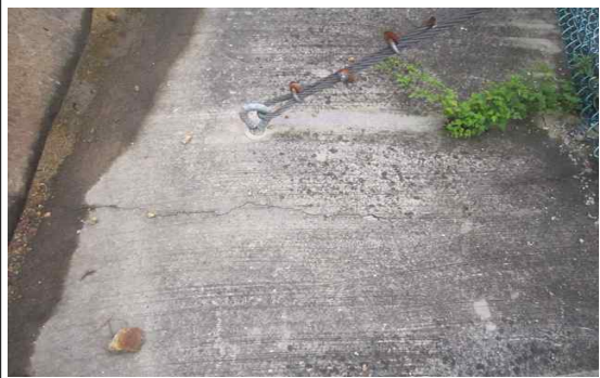
1소단배수로 균열 (78.10K 지점)
