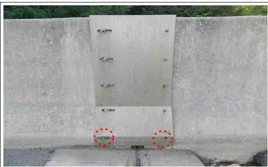
부대시설 하행선 A1 차수판 볼트 변형, 풀림
