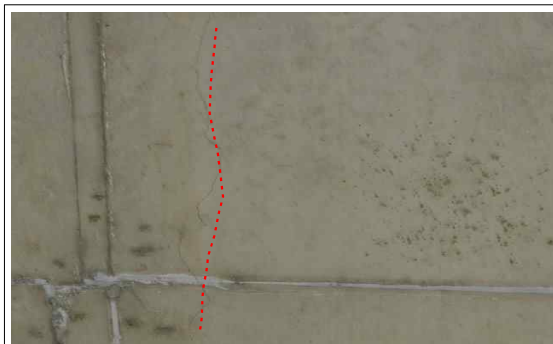
바닥판하면 상행선 S3 종방향균열(CW=0.3mm)
