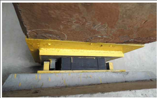
주형 하행선 S1-G3 플레이트 매립부 파손
