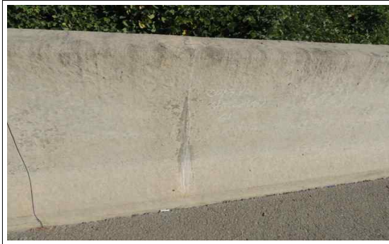
방호벽 상행선 S1 수직균열(CW=0.2mm)
