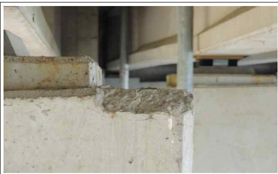
교각 하행선 P2 코핑부 파손
