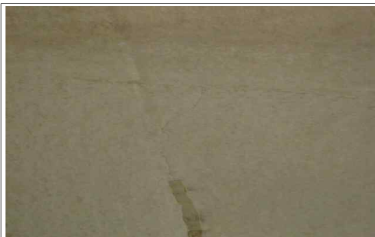
하행선 천정부 S78 균열 (폭 0.3mm)
