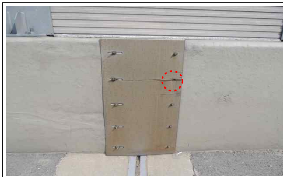
부대시설 상행선 A2 차수판 볼트 탈락
