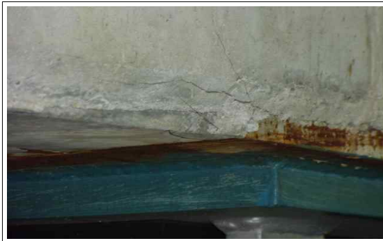
주형 상행선 S3-G3 플레이트 매립부 파손
