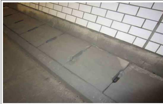
상행선 공동구 S30 덮개파손
