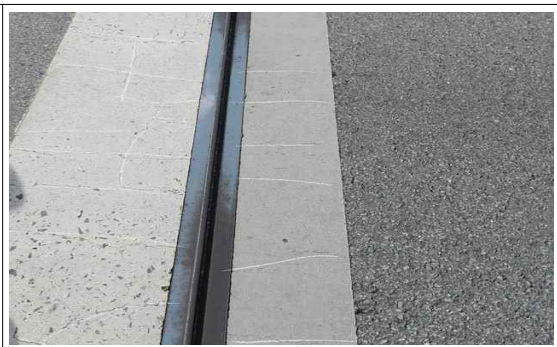
신축이음 하행선 EXP.J3(A2) 후타재 균열 (CW=0.3mm)
