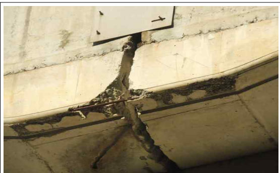
바닥판하면 하행선 S3(P2) 파손 및 철근노출
