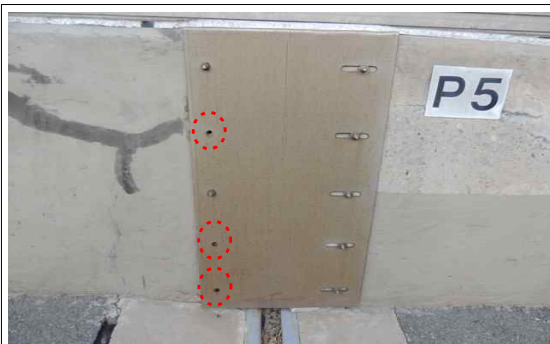
부대시설 상행선 P2 차수관 볼트탈락
