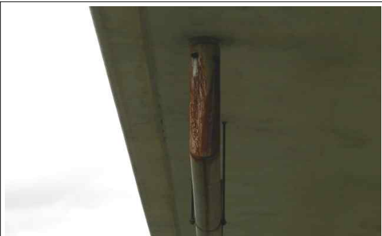
배수시설 상행선 S13 배수관 녹발생
