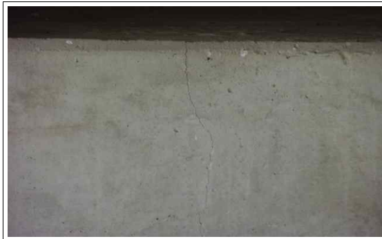
교각 상행선 P1 코핑부 수직균열(CW=0.3mm)
