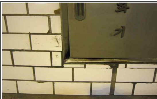
하행선 측벽부 S83 소화전 파손
