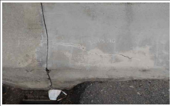
방호벽 상행선 S10 수평균열(CW=0.2mm)
