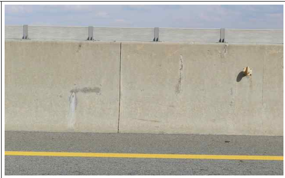
중분대 하행선 S3 균열부 백태(CW=0.1mm)
