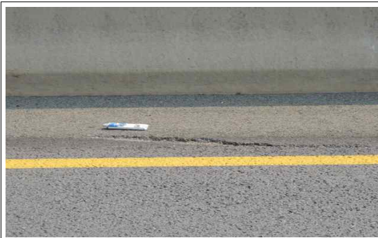
교면포장 하행선 S12 아스콘 패임
