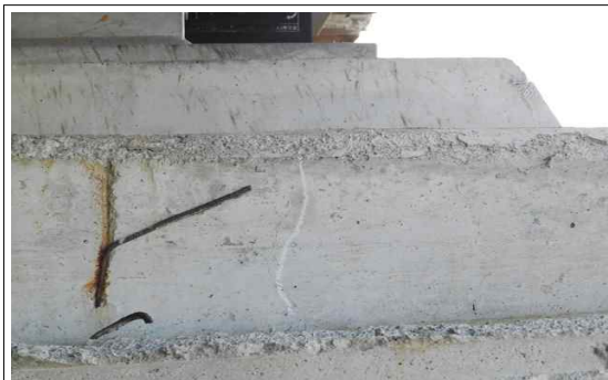
교량받침 상행선 P3-SH1 받침콘크리트 균열 (CW=0.1mm)
