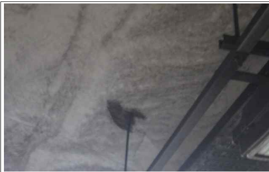
상행선 천정부 S92 앵커부 파손
