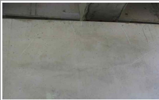
교각 상행선 P2 코핑부 수직균열(CW=0.1mm)
