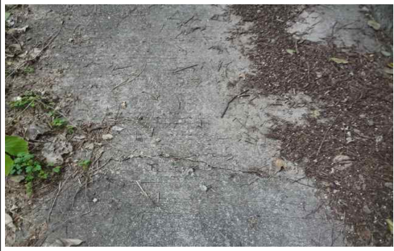
사면(종점부) STA.0-25m 소단배수로 균열
