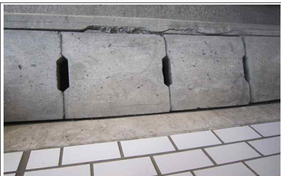
상행선 공동구 S2 콘크리트 파손
