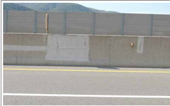
중분대 상행선 S7 보수부 재균열(CW=0.2mm)
