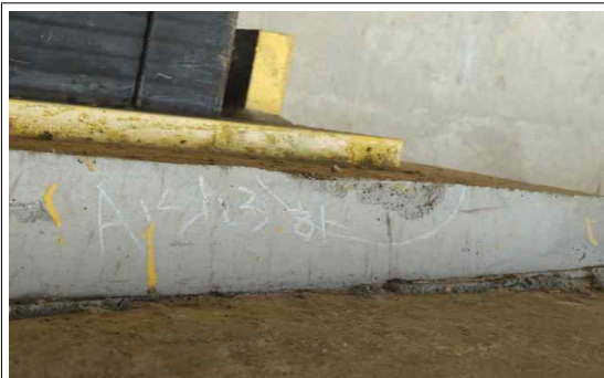
교량받침 하행선 A1-SH3 무수축물탈 파손
