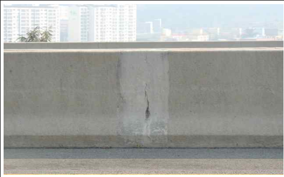
방호벽 하행선 S20 보수부 재균열(CW=0.2mm)
