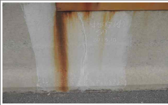
방호벽 상행선 S7 보수부 재균열(CW=0.1mm)
