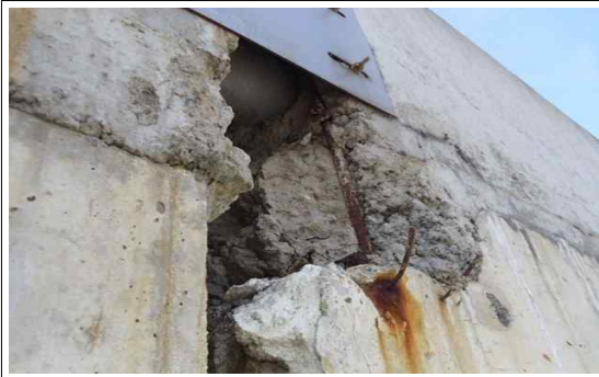
바닥판하면 상행선 S7 파손 및 철근노출
