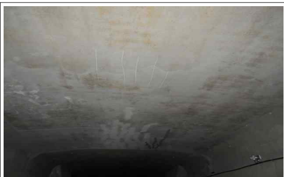
주형내부 상행선 S17 상부 종방향 균열 (CW=0.1mm)
