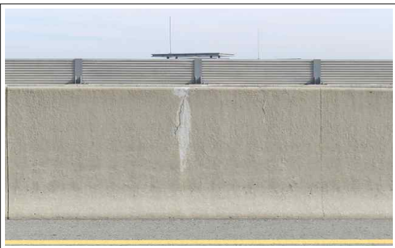
중분대 하행선 S4 균열부 백태(CW=0.1mm)
