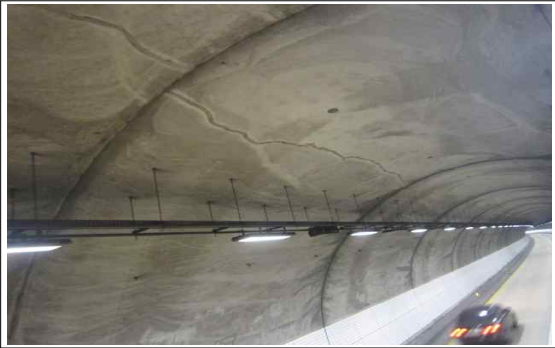
상행선 천정부 S36 재균열 (폭 0.3mm)
