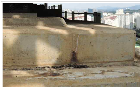
교량받침 하행선 P2-SH1 받침콘크리트 철근노출
