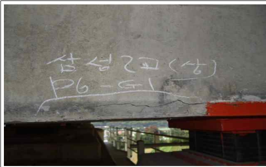
주형 상행선 S6-G1 플레이트 매립부 파손
