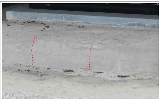
교량받침 상행선 P3-SH10 받침콘크리트 균열 (CW=0.1mm)
