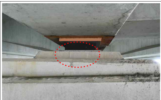
교량받침 상행선 P4-SH1 무수축물탈 균열 (CW=0.1mm)
