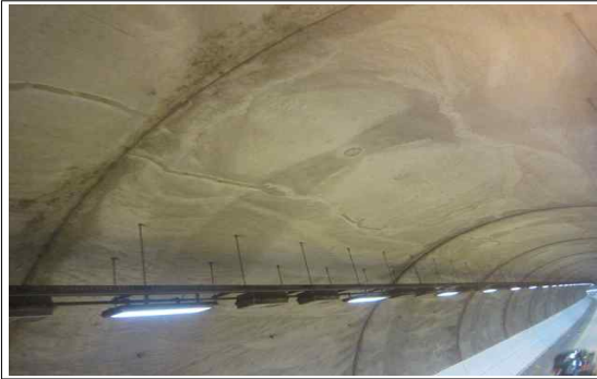
상행선 천정부 S24 재균열 (폭 0.3mm)
