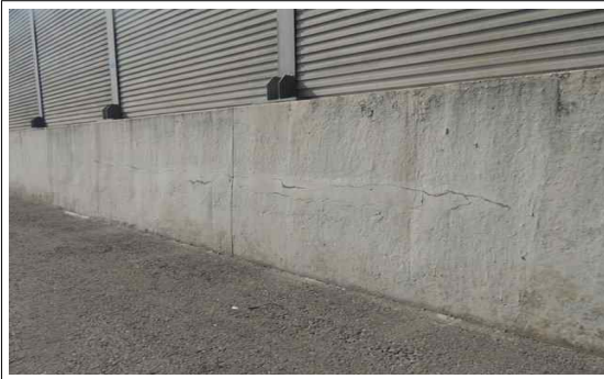
방호벽 하행선 S1 보수부 재균열(CW=0.2mm)
