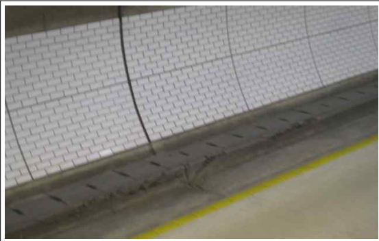
상행선 공동구 S33 콘크리트 파손
