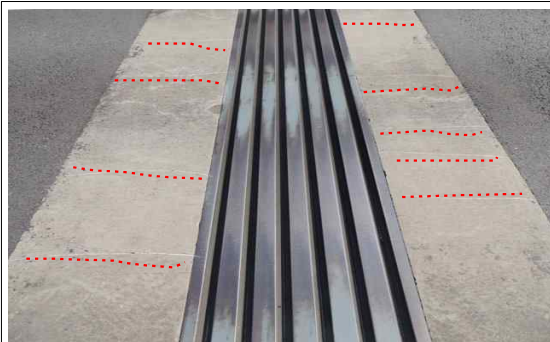
신축이음 하행선 Exp.J1(A1) 후타재 균열 (CW=0.3mm)
