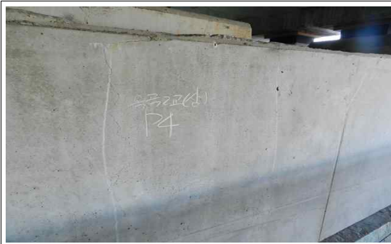
교각 상행선 P4 코핑부 수직균열(CW=0.2mm)
