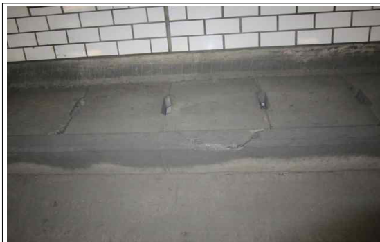
상행선 공동구 S90 콘크리트 파손
