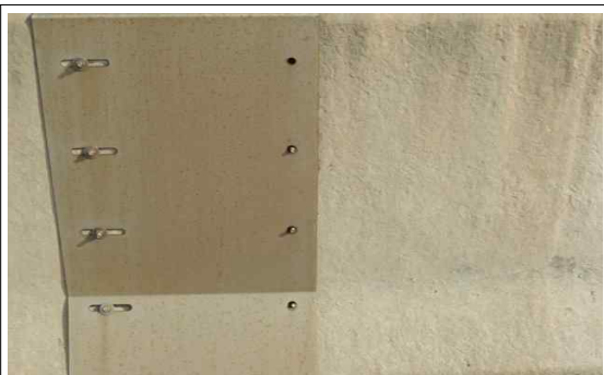
부대시설 상행선 A2 차수관 앵커탈락
