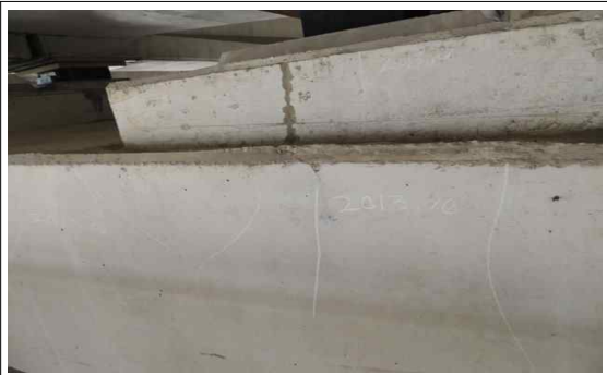
교각 하행선 P1 코핑부 수직균열(CW=0.1mm)
